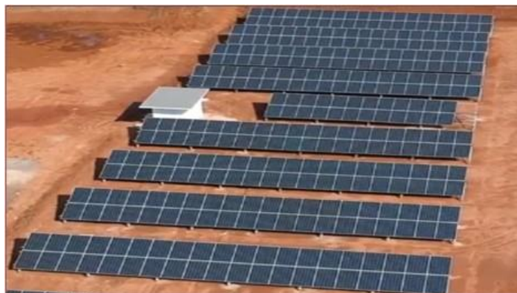
Figura 6: Vista aérea da fazenda solar.
