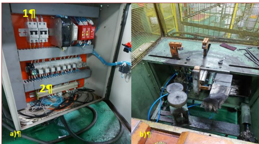
Figura 1: a) Painel elétrico usado antes da implementação do sistema de automação; b) Local de processamento das peças anterior à automação.
