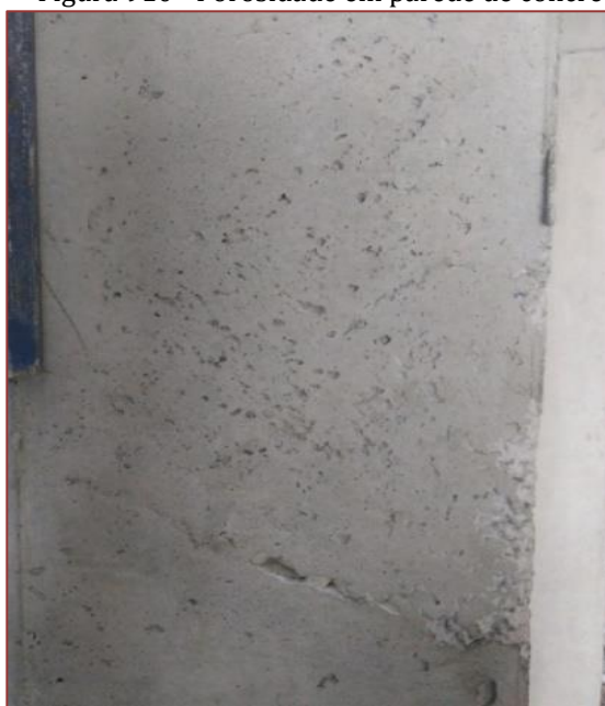
Figura 910 - Porosidade em parede de concreto
