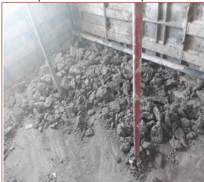
Figura 13 - Desperdício de concreto causado pela abertura dos painéis
