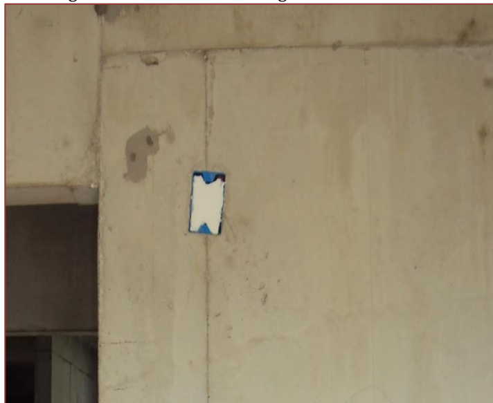
Figura 1112 - Caixa de Passagem desalinhada
