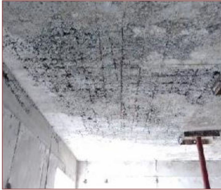
Figura 1011 - Armadura da Laje exposta
