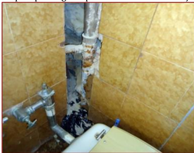
Figura 2 – Principais patologias apresentadas nas instalações hidráulicas.
