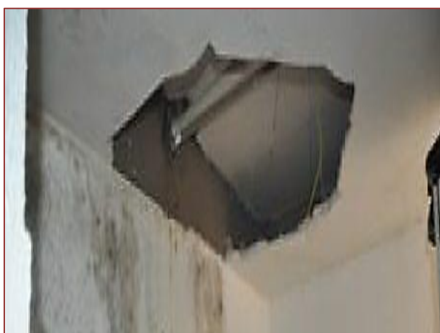
Figura 4 – Falha na execução do projeto
