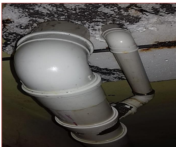
Figura 5 – Falha na execução do projeto.
