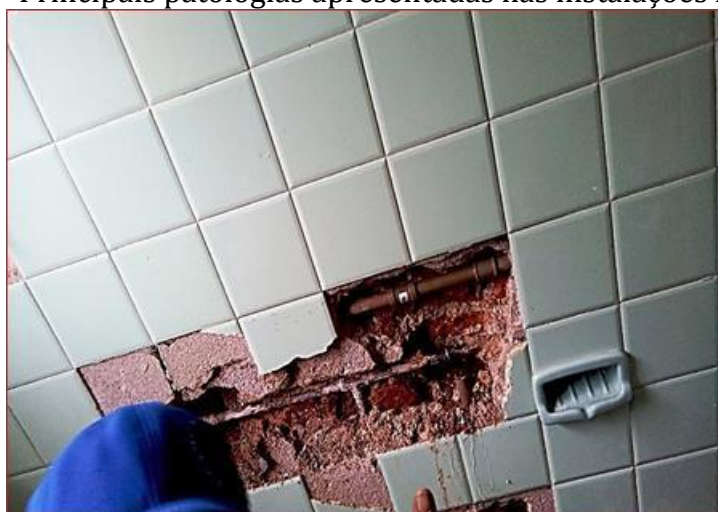
Figura 3 – Principais patologias apresentadas nas instalações hidráulicas.
