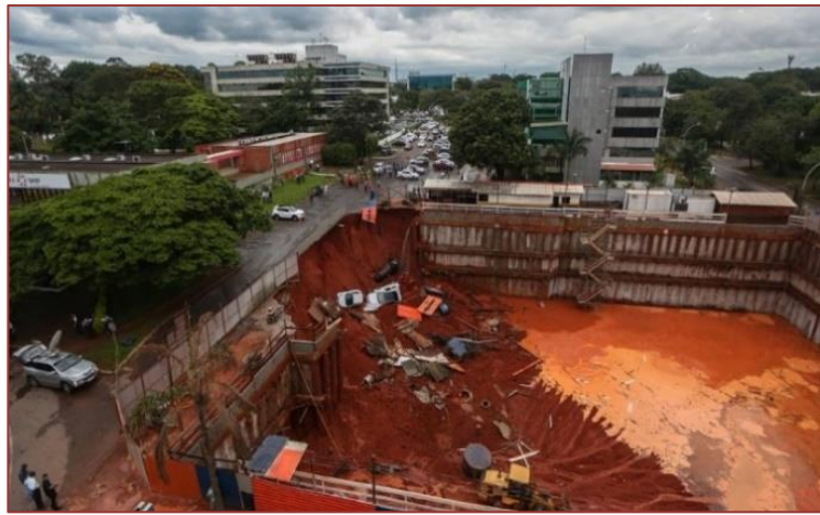
Figura 4- Deslizamento de terra
