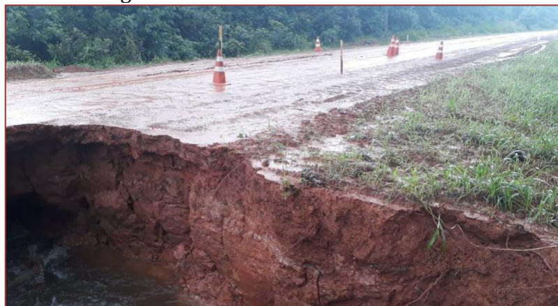
Figura 2 – Processo erosivo da BR-319
