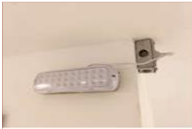
Figura 13 – Iluminação de emergência
