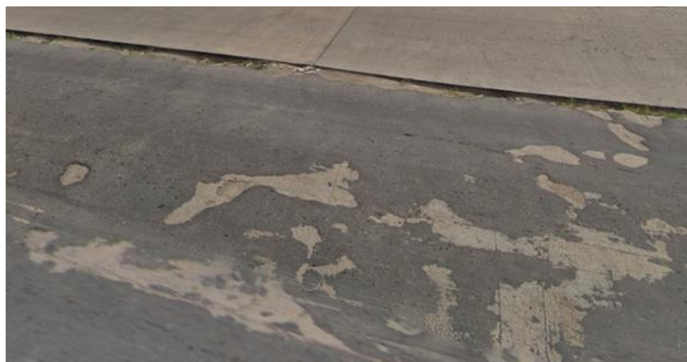
Figura 11 – Remendos para selar rachaduras e passagem de nível
