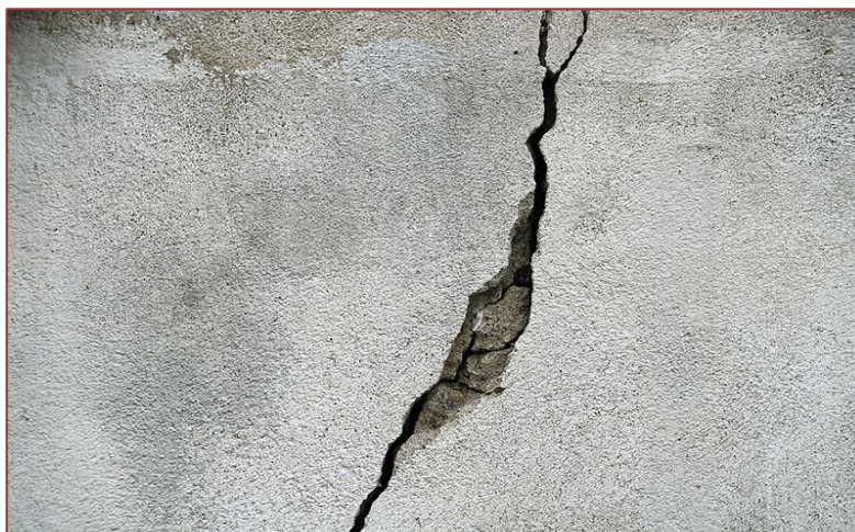
Figura 2 – Rachadura apresentada na parede de concreto de um edifício
