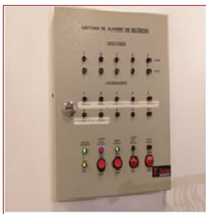
Figura 7 – Central de alarme e detecção de incêndio
