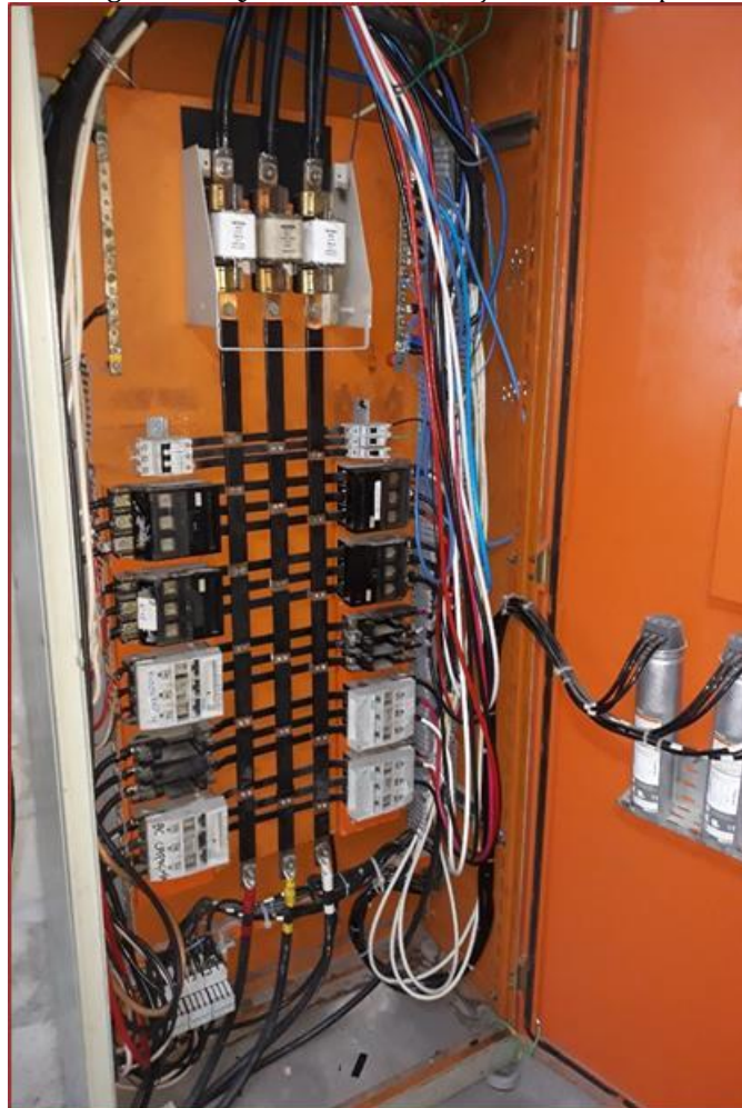
Figura 25 - Quadro de Distribuição do RoofTop.
