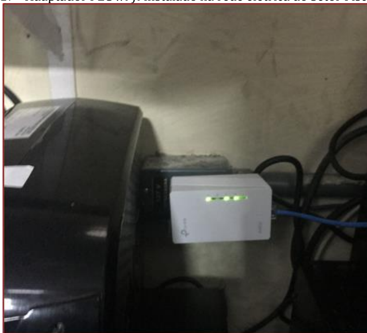
Figura 17 - Adaptador PLC wi-fi instalado na rede elétrica do Setor Fiscalização.
