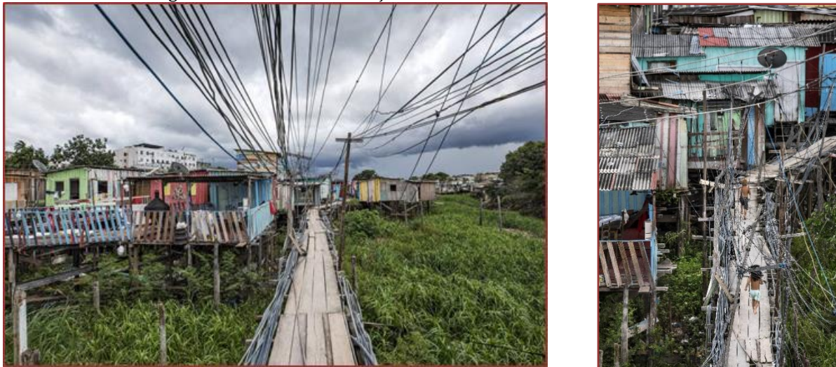
Figura 2 - Sistema de instalação elétrica em comunidades de Manaus.
