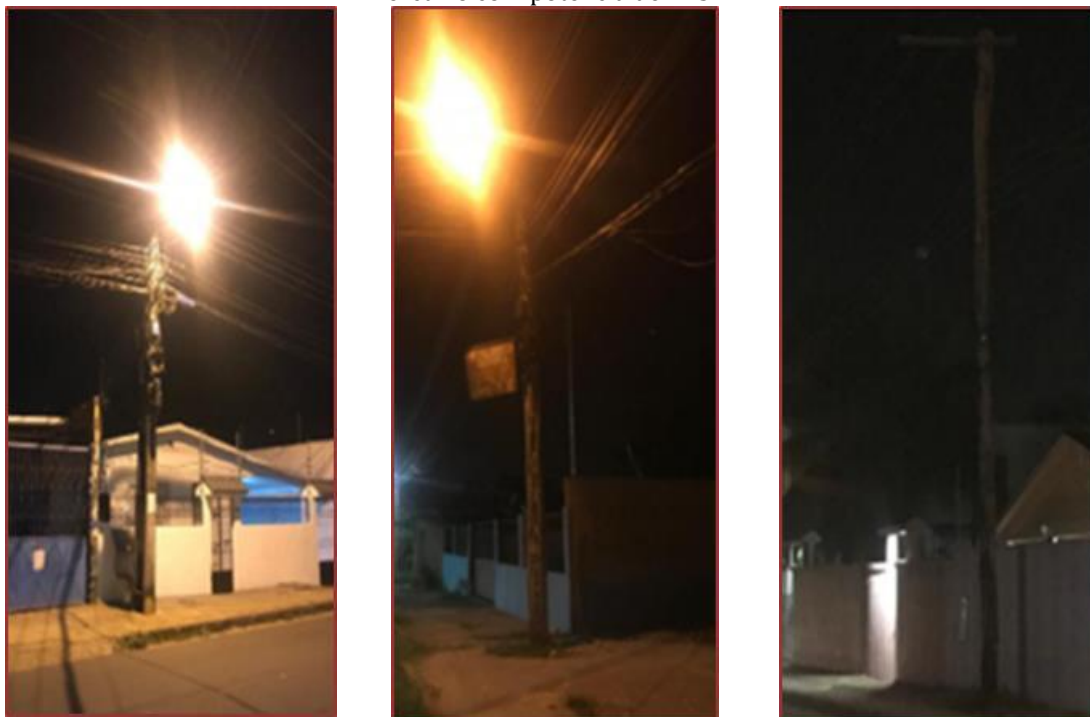
Figura 2- Ruas do Bairro Biribiri apresentado os pontos de iluminação com lâmpadas de vapor de mercúrio com potência de 125 W.
