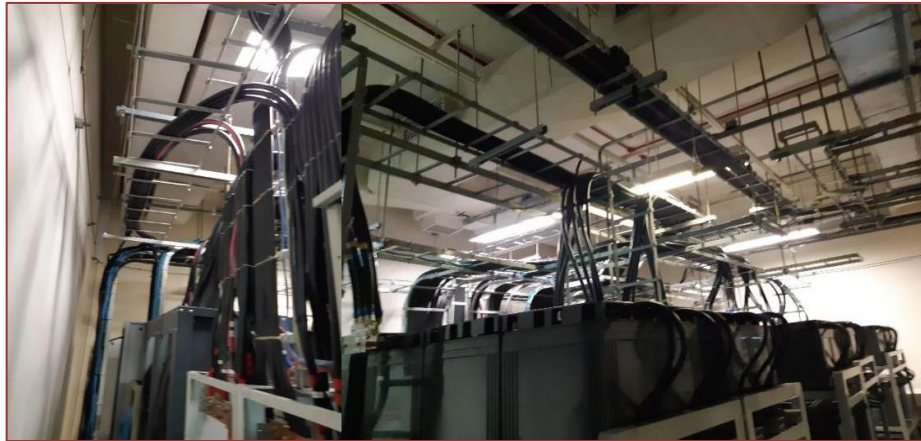
Figura 7. Esteiramento de conexão dentro da estação de telecom
