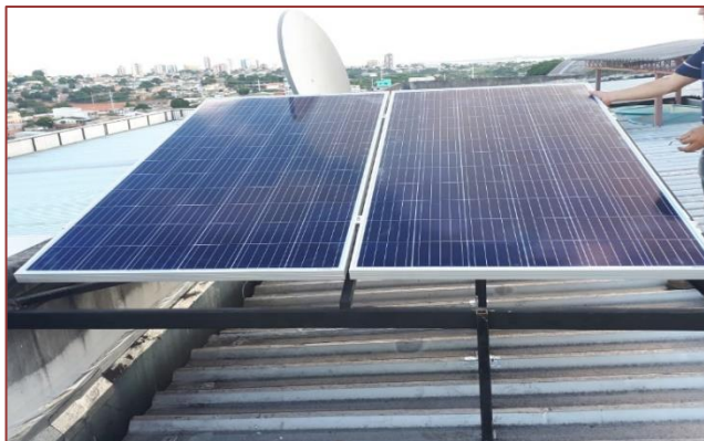
Figura 3: Pannel fotovoltaico, foto no local do projeto piloto
