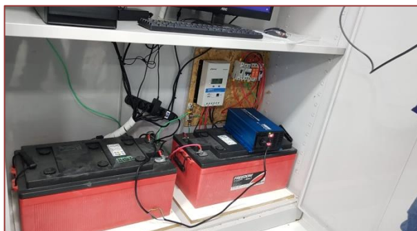
Figura 4. Banco de baterias, foto no local do projeto piloto
