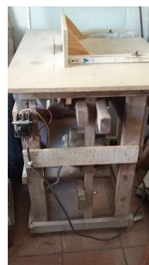
Figura: 5, notando fiação solta
