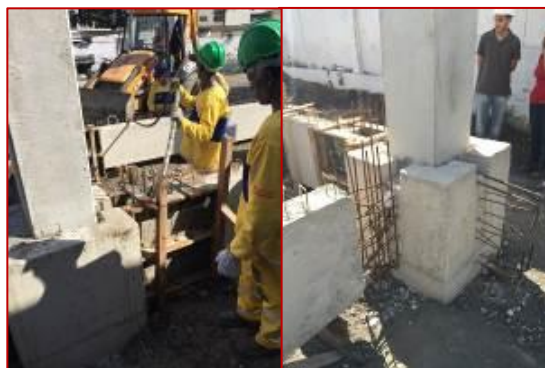
Figura 8. Consolidação no local da ligação da viga de travamento com o pilar
