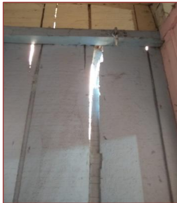
Foto 4. Fissuras na madeira
