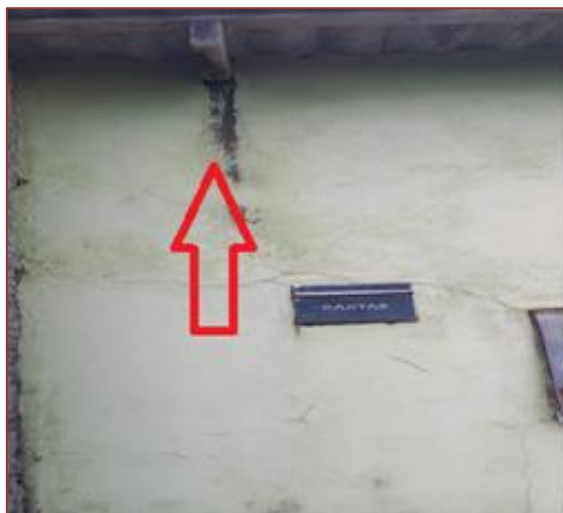
Figura 4. Fissuras e Trincas
