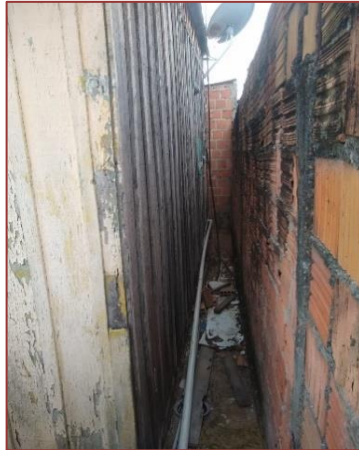
Foto 3. Encanação exposta e deslocamento de pintura
