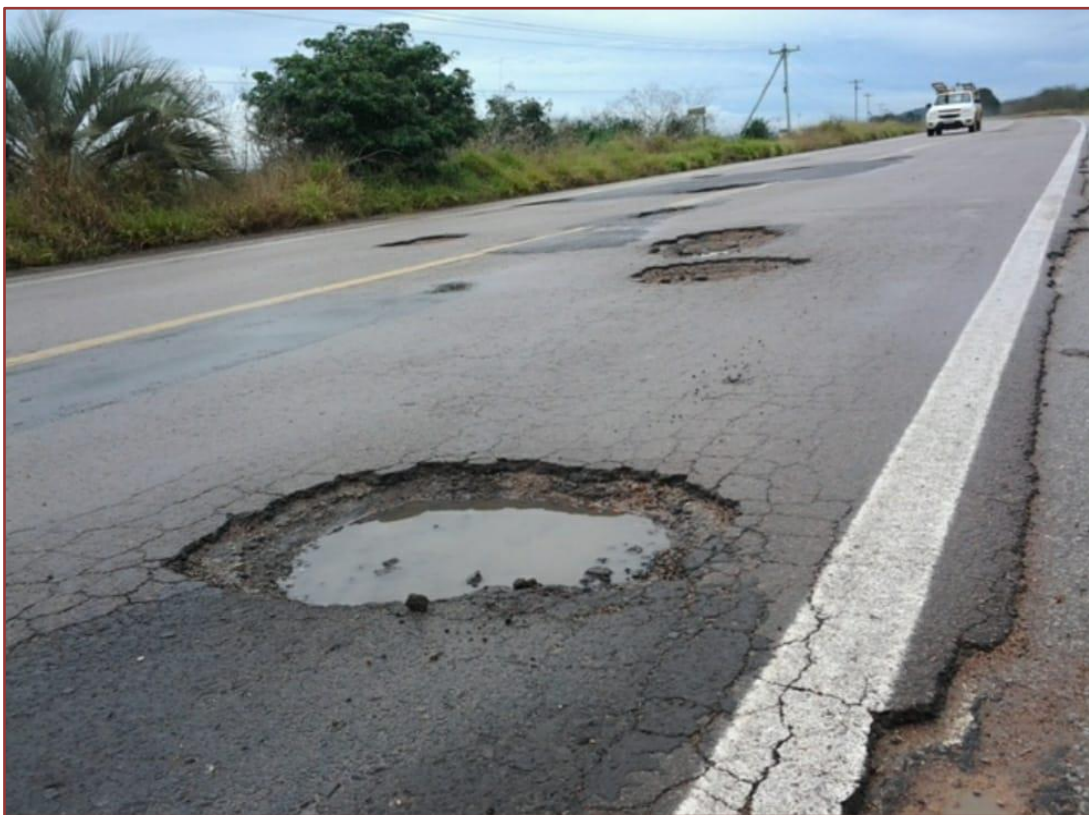
Figura 3. Patologias do tipo buraco.
