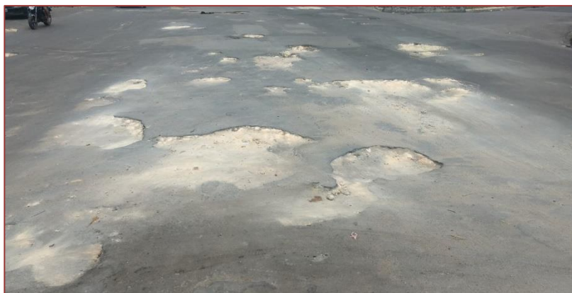
Figura 9. Patologia Painel ou buraco.
