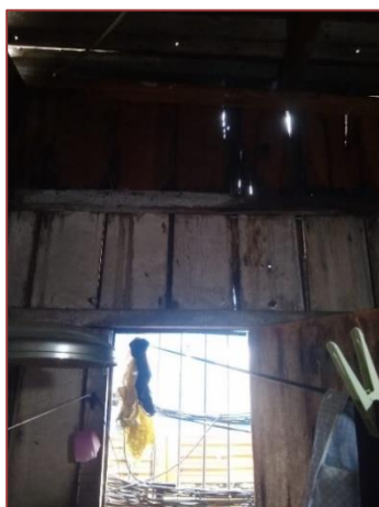
Foto 7. Fissuras, trincas e goteiras
