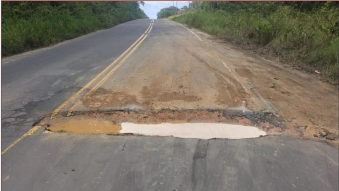
Figura 2. Patologia do tipo buraco.
