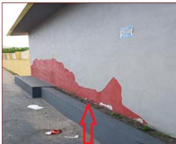
Figura 5. Deslocamento de Pintura
