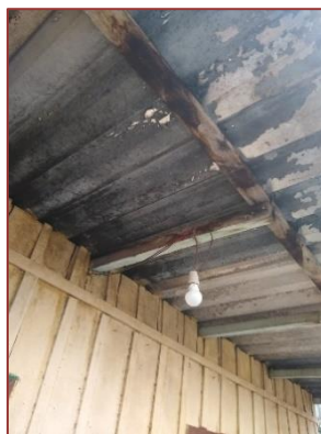
Foto 2. Fiação elétrica exposta
