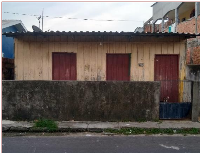
Foto 1. Frente da residência, e se nota eflorescências e mofo já na entrada
