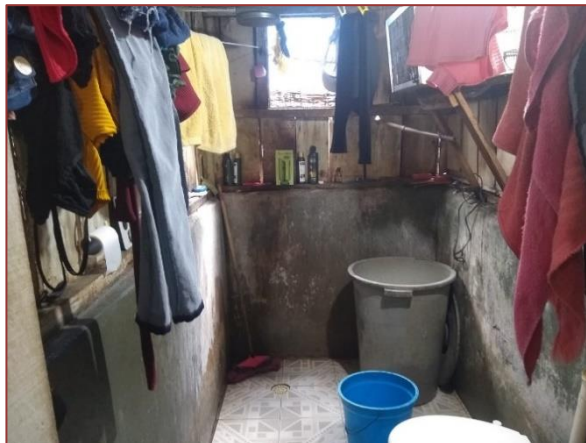
Foto 5. Banheiro da residência, nota -se fungos, mofo, eflorescência, ferrugens
