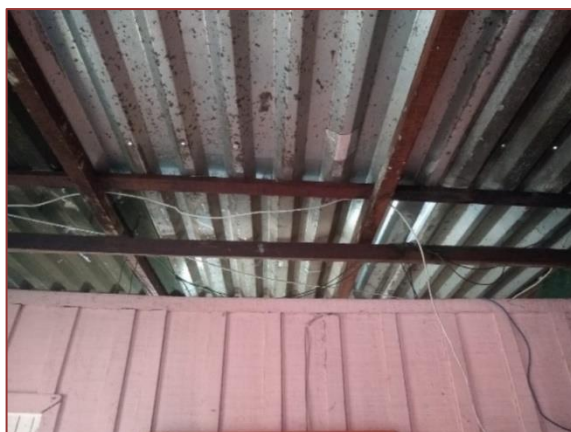
Foto 8. Fios elétricos expostos junto com goteiras
