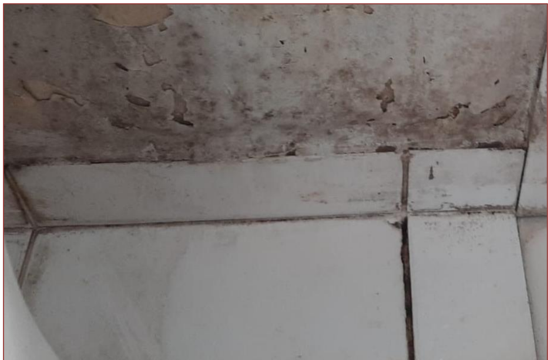
Figura 4. Infiltração identificada no Rodapé no Banheiro
