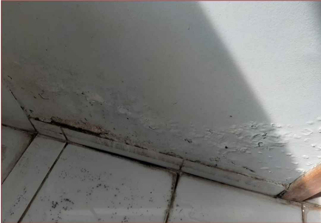
Figura 3. Infiltração identificada no Rodapé no Banheiro
