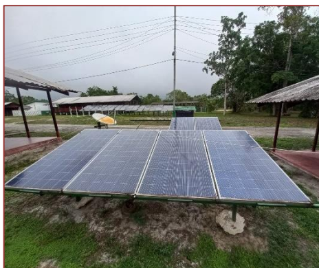
Figura 2. Geração Distribuída do 5º PEF/Maturacá-AM
