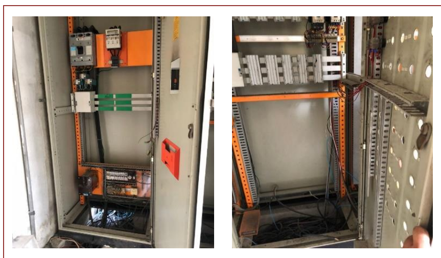
Figura 1: Painel de força antes do Retrofit
